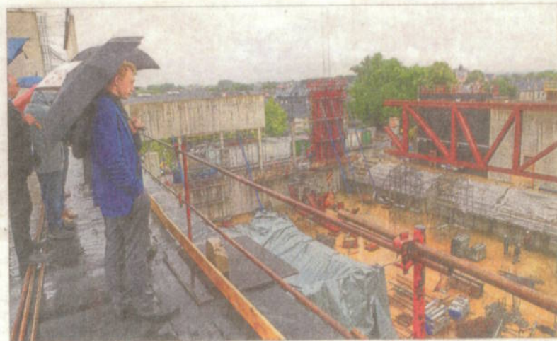
Vom obersten Stockwerk des „Centre sportif René Hartmann“ bietet sich ein Blick über die gesamte Baustelle. Im Oktober 2015 soll hier wieder sportliches Treiben Einzug halten. (FOTO: TANJA FELLER)
